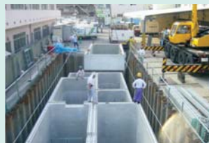
■ 川崎食品産業株式会社 排水処理設備工事風景 40m 3 ユニット槽×7槽
