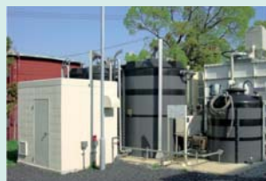
■ 株式会社島津製作所 10m 3 /日厨房&洗浄排水処理設備 備鉛物油の混じる洗浄水も同時処理
