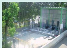
■ 極東開発工業株式会社 50m 3 /日鉛物油排水処理設備 高濃度鉛物油も流出ストップ
